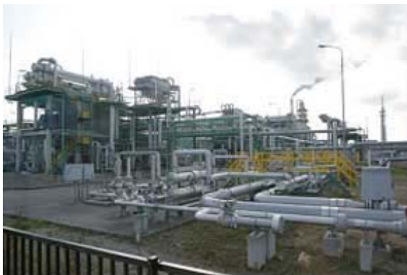
勇払油ガス田の生産設備
