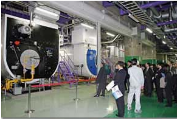
効率的な運転のために2種類4台が設置されている蒸気ボイラ
